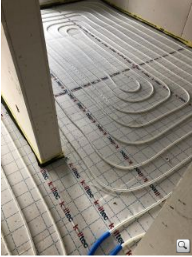
Referenz: HAUNSTETTER HÖFE in Augsburg, 3500 m 2 Fußbodenheizung, © keiltec GmbH
