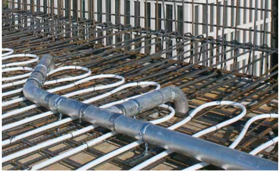
Betonkernaktivierung + Lüftung im Neubau Sprach- und Kulturwissenschaften in Frankfurt am Main.
